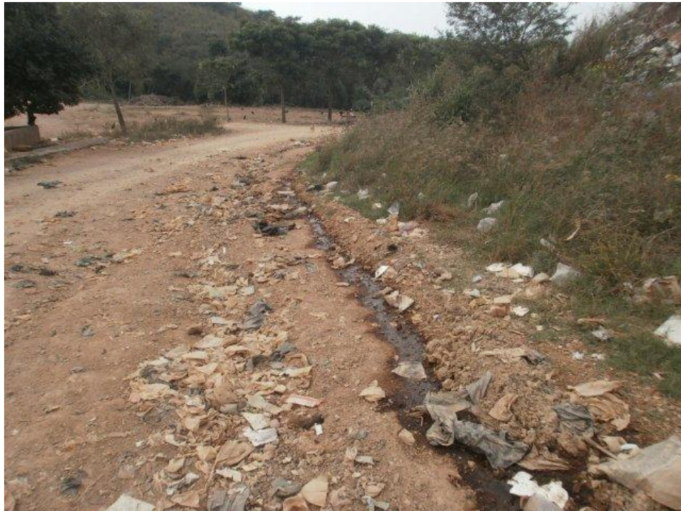
Flujo superficial de lixiviados en el pie del talud del relleno sanitario.
